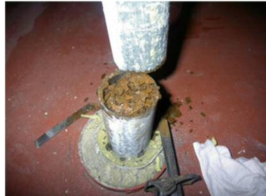
空調ドレン管夾雑物状況（経年 19 年）
