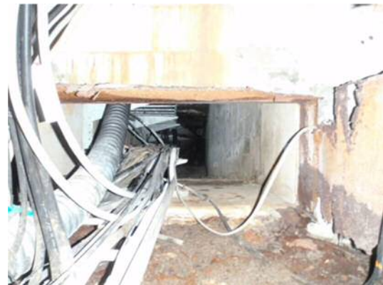
電気配管配線劣化状況（経年 20 年）
