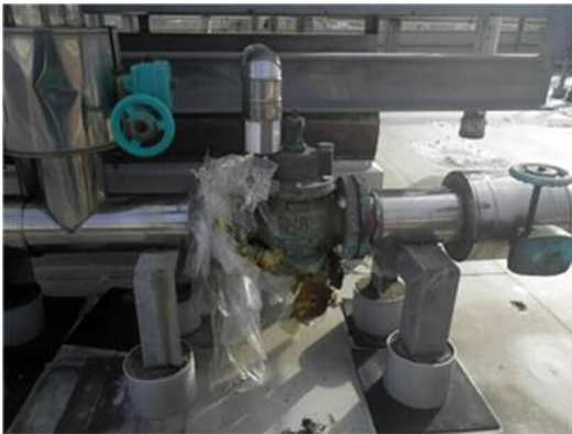
高置水槽廻り定水位弁故障（経年 20 年）
