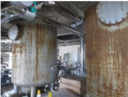
井水ろ過器老朽劣化状況（経年 20 年）
